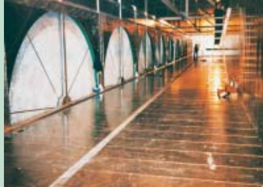
Über die Wärmeräder in der Lackierung werden ca. 700 000 m 3 Luft in der Stunde ausgetauscht
