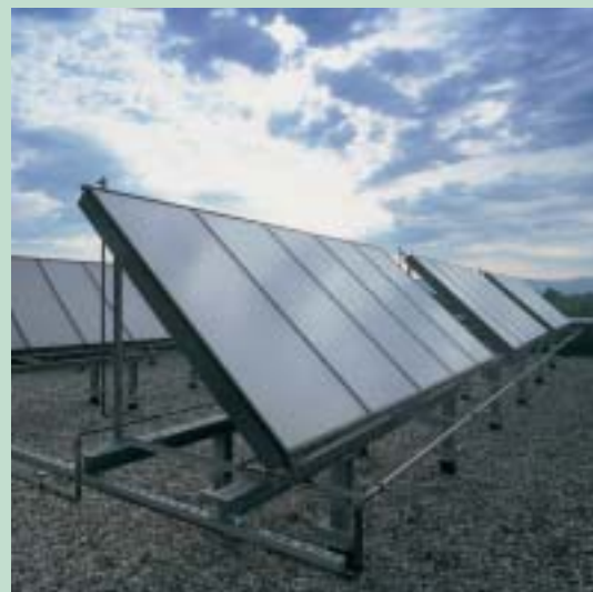
Solarkollektoren mit ca. 100 m 2 Fläche auf dem Dach der Energiezentrale
